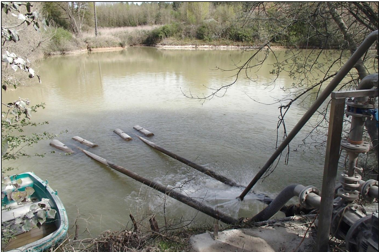
Le bassin de décantation des eaux d'exhaure
